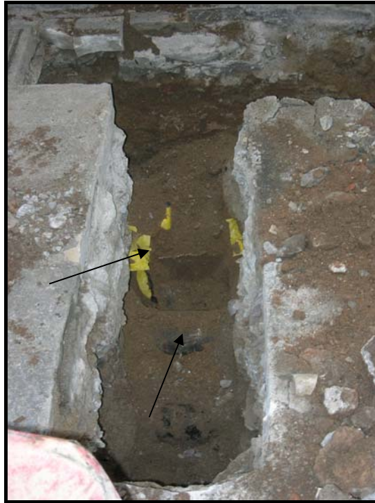
3. Cata corresponent a l'inici de la rasa. S'aprecien els serveis de llum i gas detectats al llarg de tota la rasa.
