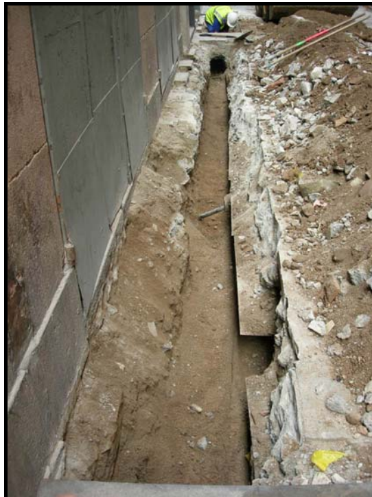
4. Primer dels dos trams realitzats. S'aprecien els serveis elèctrics al lateral dret de la rasa.
